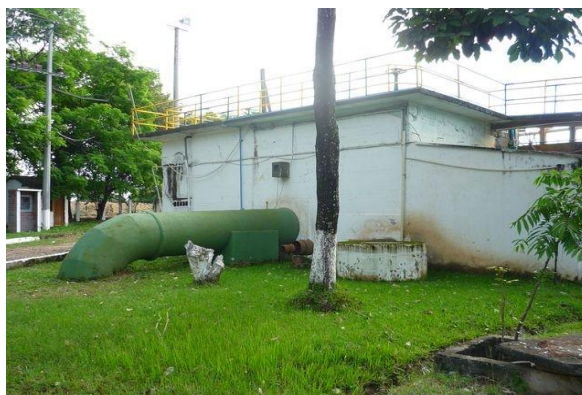
Figura 7 Zona de Captación del Afluyente acueducto El Jardín.
