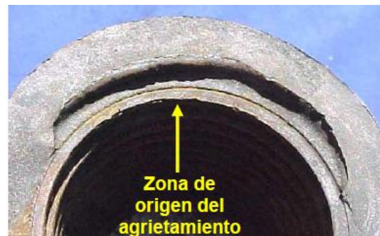
Figura 45. Origen del agrietamiento.
