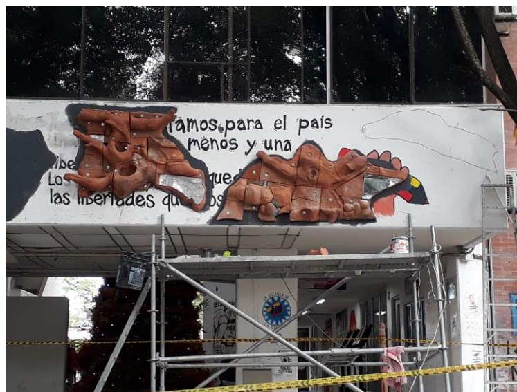
Figura 159. Fase de Instalación. Montaje de los fragmentos y láminas metálicas, con chazos expansivos. Lugar: Ágoras Usco.
