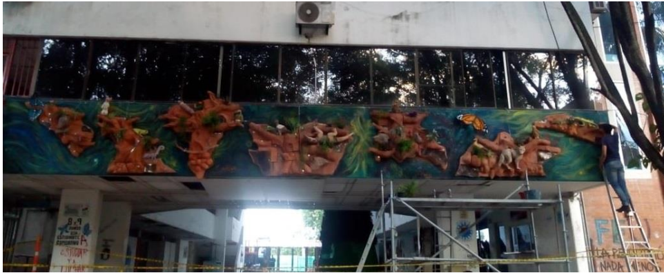
Figura 168. Fase de Instalación. Aplicación pictórica a los fragmentos y láminas de metal.
