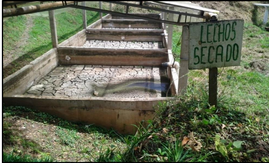
Figura 13. Lecho de secado de lodos.
