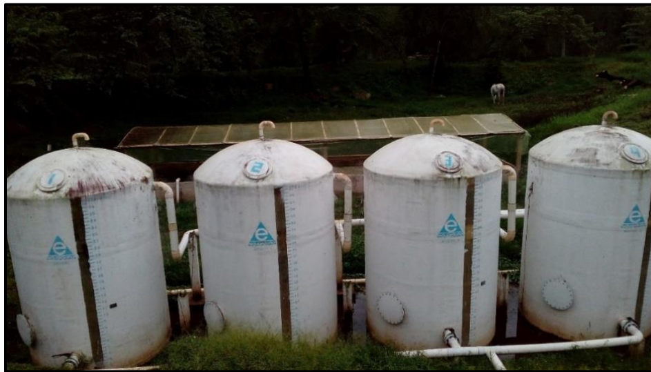
Figura 11. Filtros Anaerobios de Flujo Ascendente (FAFA).
