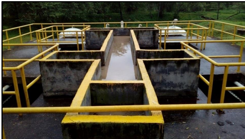
Figura 10. Trampa grasas, Canal de Distribución y RAFA.
