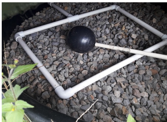
Figura 17 Acondicionamiento interior de la recamara de dosificación.
