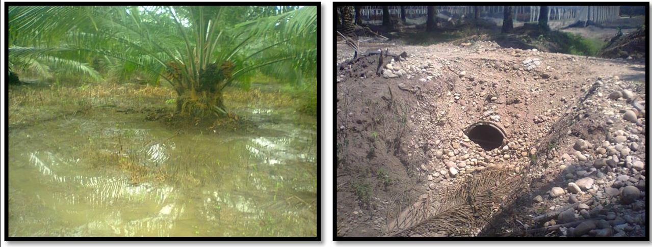
Figura 33. Evidencias de zonas con problemas de Drenaje.
