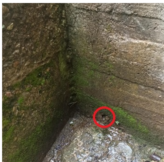
Figura 4. Fuga de agua en muro de contención.
