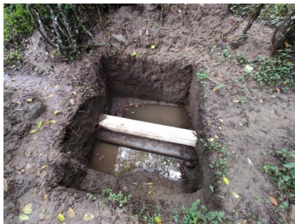
Figura 11. Apique encontrado en tubería de aducción.
