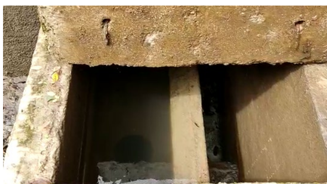
Figura 18. Vertedero de salida desarenadores.
