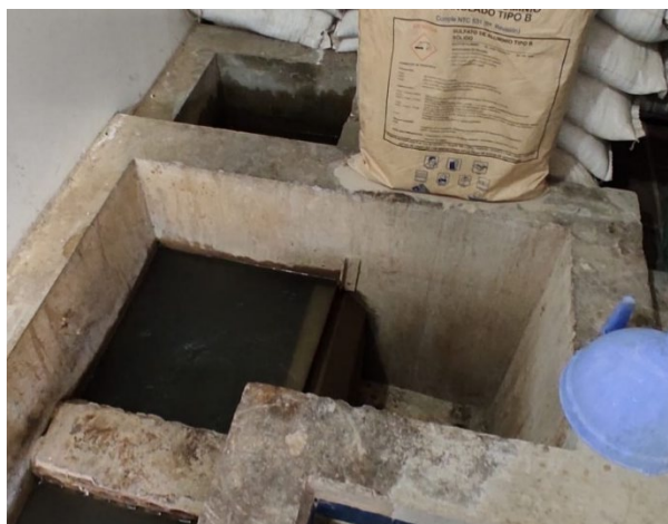
Figura 25. Vertedero canaleta Parshall.
