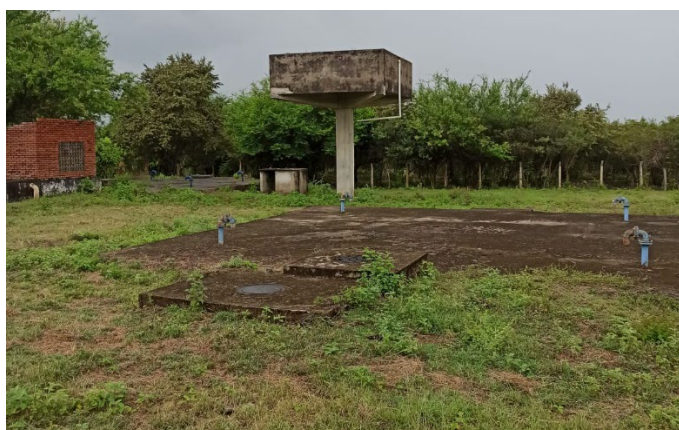
Figura 35. Tanque de almacenamiento 2 y tanque elevado para lavado de filtros.
