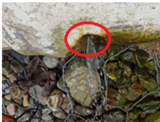
Figura 21. Fuga tubería de conducción 10".
