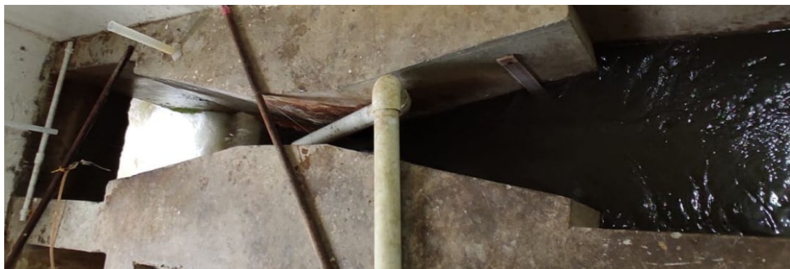
Figura 24. Canaleta Parshall, mezcla rápida de tipo hidráulica.
