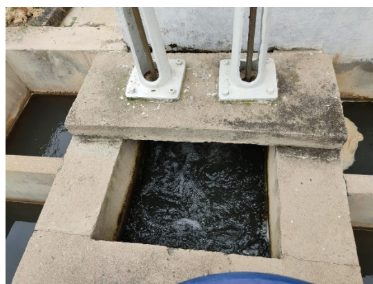
Figura 28. Entrada del flujo a los floculadores.
