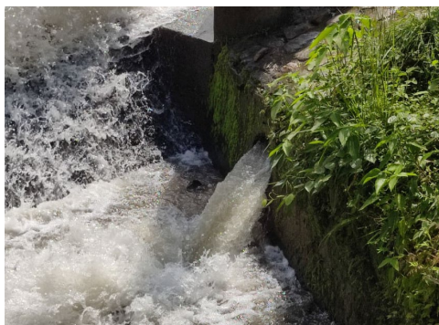
Figura 10. Tubería de excesos 12"
