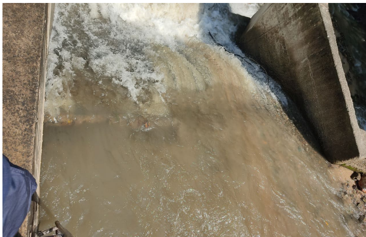
Figura 3. Bocatoma de fondo.
