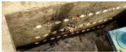
Figura 15. Perforaciones de tubería PVC 3" entrada del desarenador.
