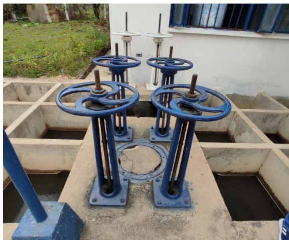
Figura 27. Cámara de vertedero para mantenimiento y limpieza.
