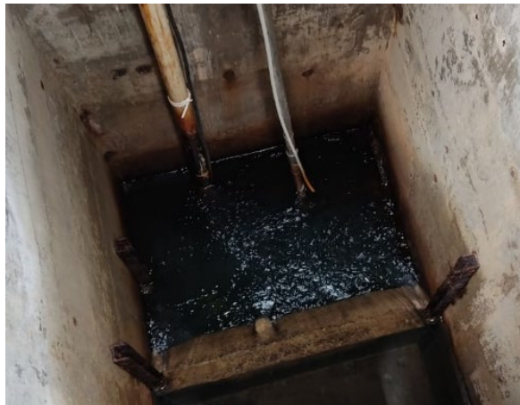
Figura 32. Cámara de salida a los tanques de almacenamiento.
