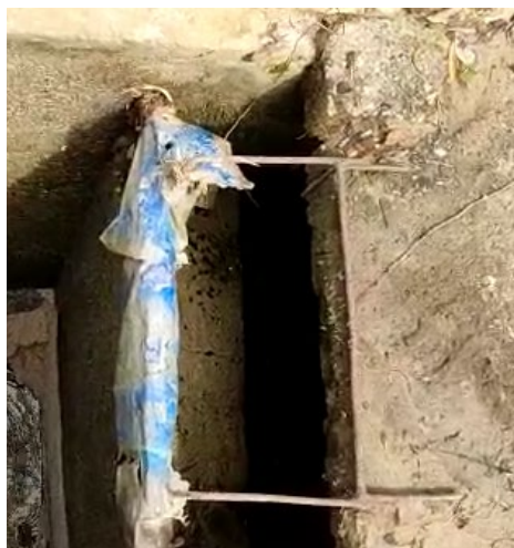
Figura 17. Entrada cámara de excesos desarenadores.
