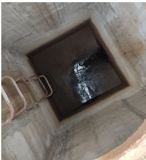
Figura 33. Cámara de desagüe y lavado de filtros.
