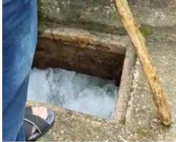
Figura 7. Primera cámara de vertedero.
