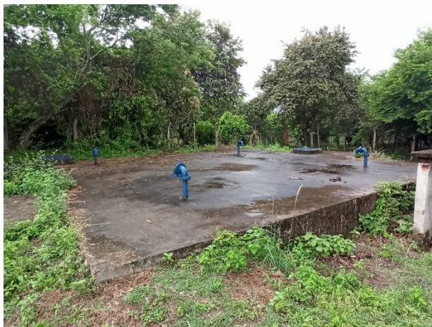
Figura 34. Tanque de almacenamiento 1.
