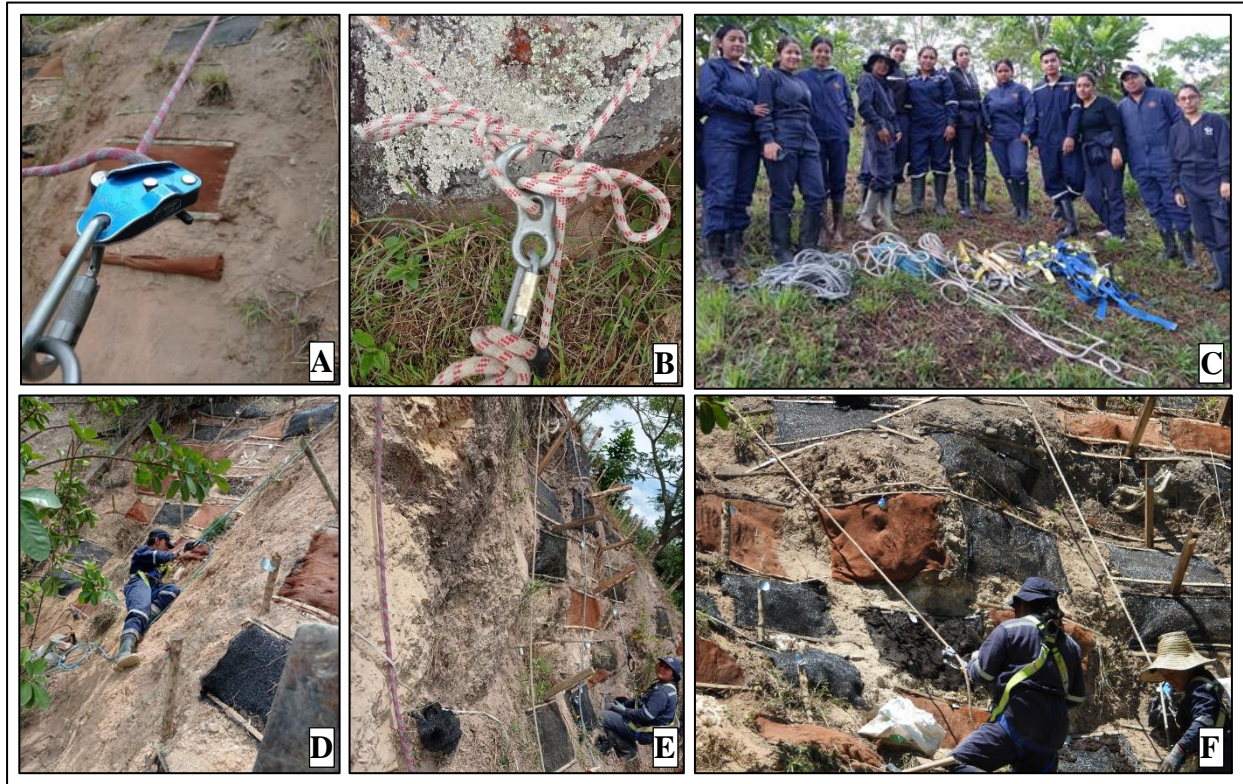
Figura 24. Equipo de trabajo en alturas (A,B y C), montaje de tratamientos en las unidades experimentales (D,E y F)
