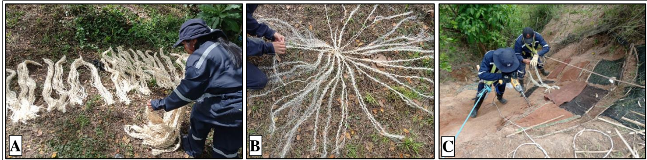
Figura 27. Alistamiento de la raíz artificial (A y B), incorporación de raíz artificial al suelo (C).
