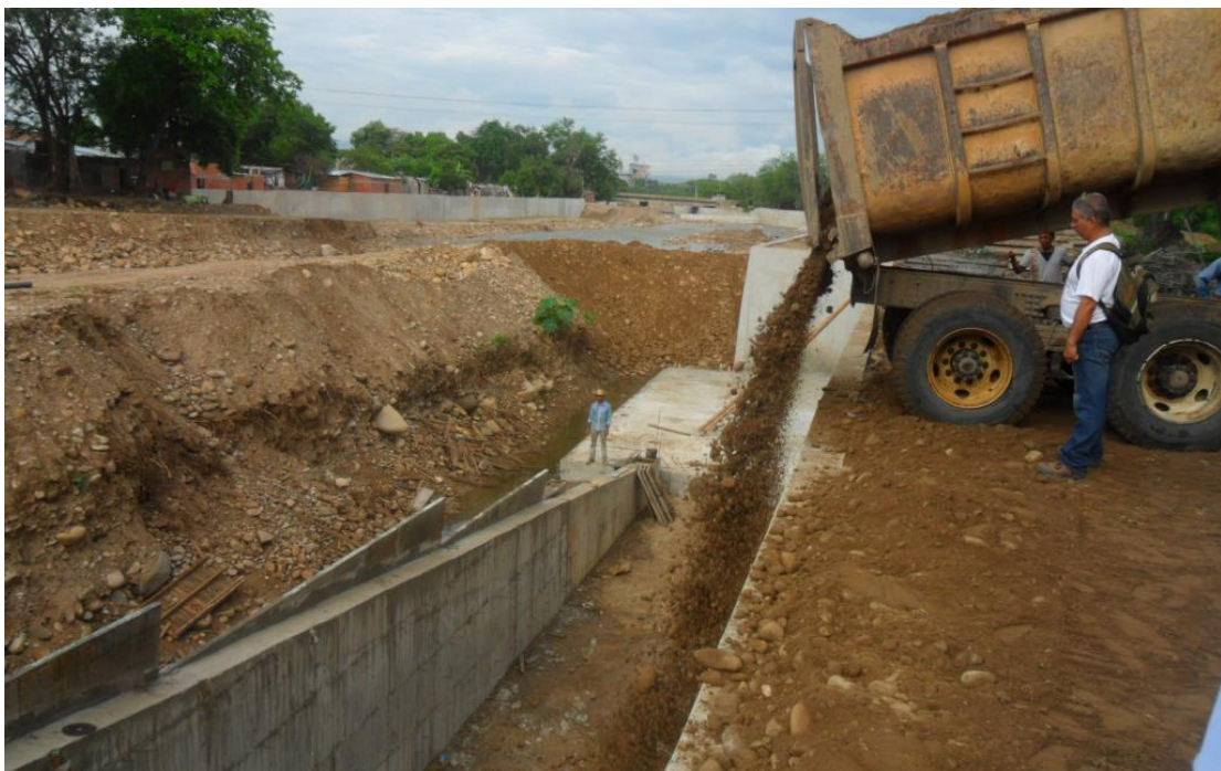
Imagen 3: Rampa de acceso #4. Llenando con material cajón entre muros de rampa 4; el cajón se llena, se compacta el material y se construyen los módulos de la plataforma
