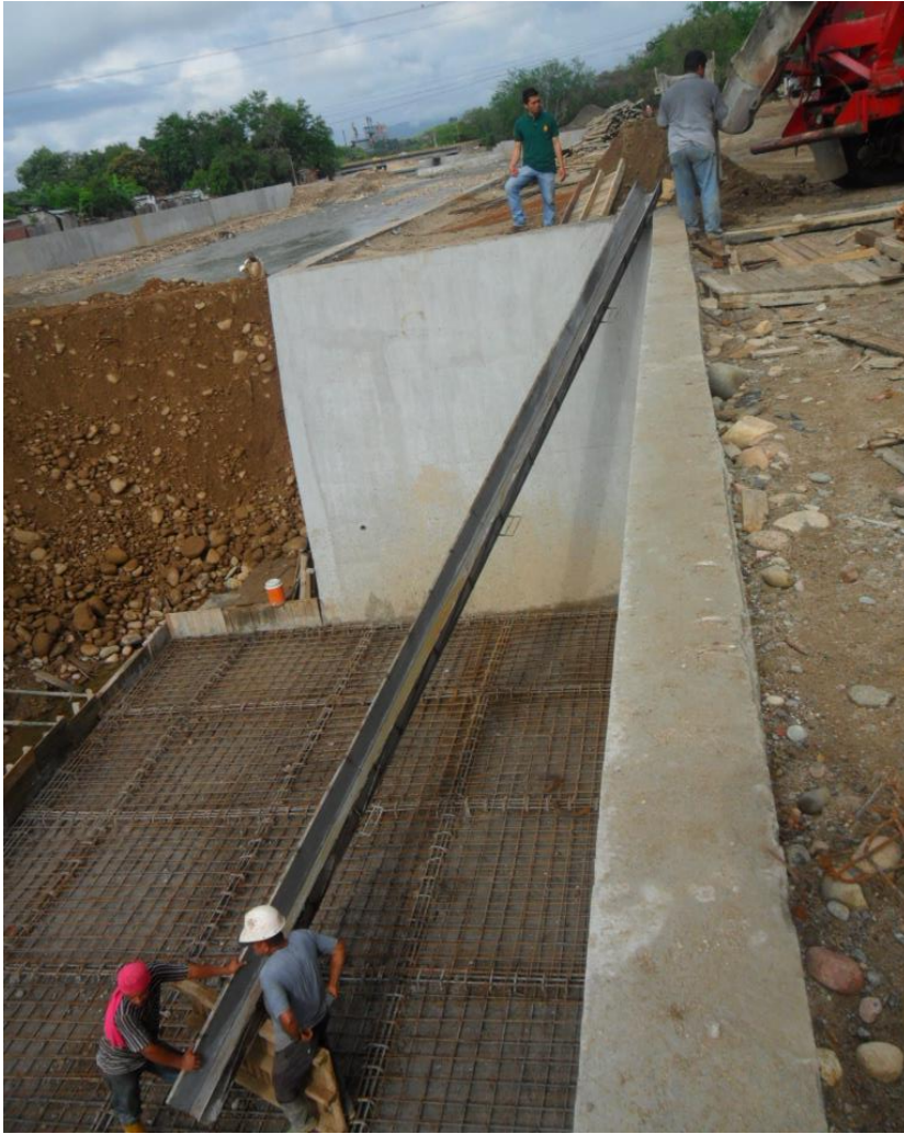
Imagen 1: Plataforma inferior rampa #4. Emparrillado de plataforma inferior y canal para poner la mezcla de concreto premezclado sobre la parrilla.
