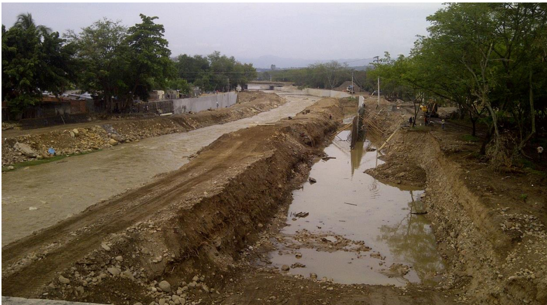
Imagen 2: Excavación para implantación de muro margen derecha. Muro de H=5,5 mts y rampa #4
